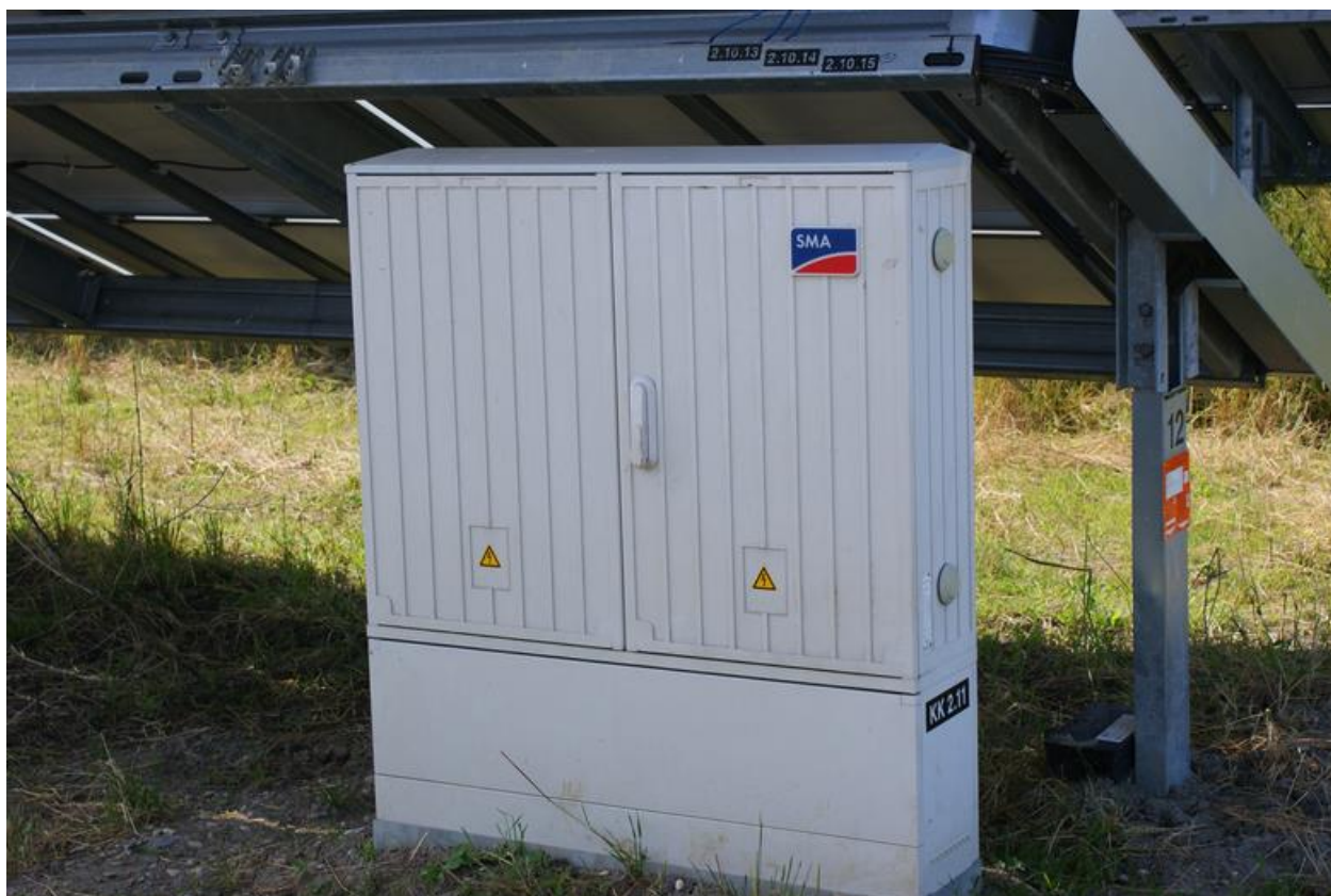
Zdjęcie nr 5. Farma fotowoltaiczna pod Parmą (Włochy), wykonana w identycznej technologii jak planowana instalacja. String-box mocowany na gruncie
