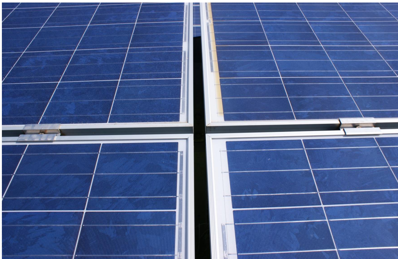
Zdjęcie nr 2. Farma fotowoltaiczna pod Parmą (Włochy), wykonana w identycznej technologii jak planowana instalacja. Widoczny sposób wzajemnego ułożenia poszczególnych modułów fotowoltaicznych.
